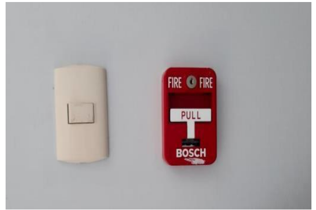
Fotografía 9: Pulsador de emergencia.
