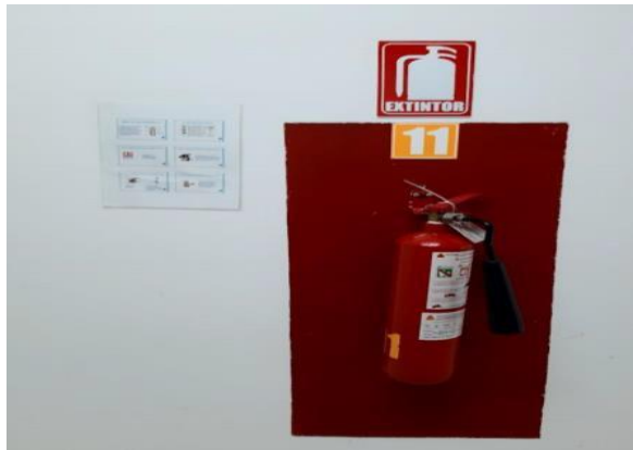
Fotografía 8: Extintor en frente de trabajo.
