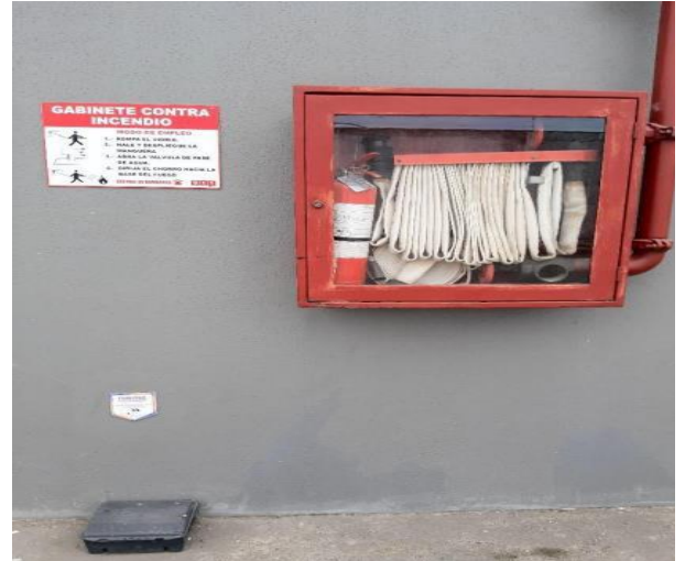
Fotografía 7: Gabinete de contra incendios.
