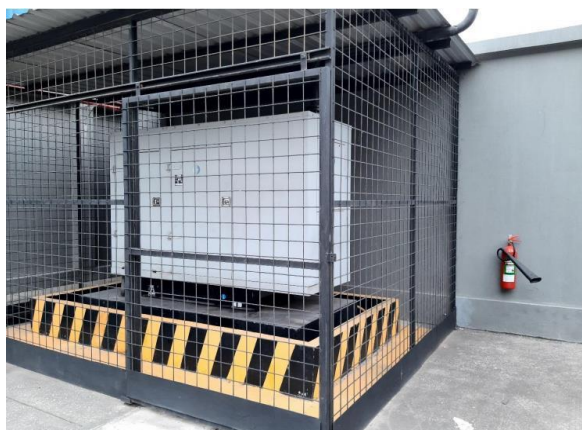
Fotografía 10: Generador de emergencia con extintor de emergencia.
