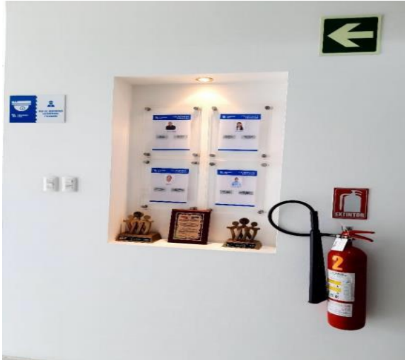
Fotografía 6: Extintores colocados en el área de oficinas.
